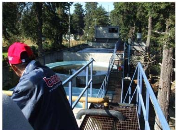
Foto 24. Planta de tratamiento de aguas
