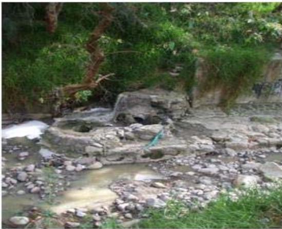
Foto 58. Pozo de visita roto
