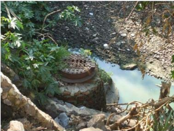
Foto 45. sistema de alcantarillado
