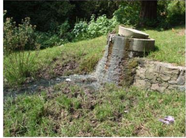
Foto 69. Pozo de visita rebosado
