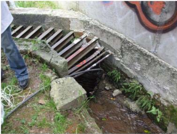
Foto 78. Colector de descargas
