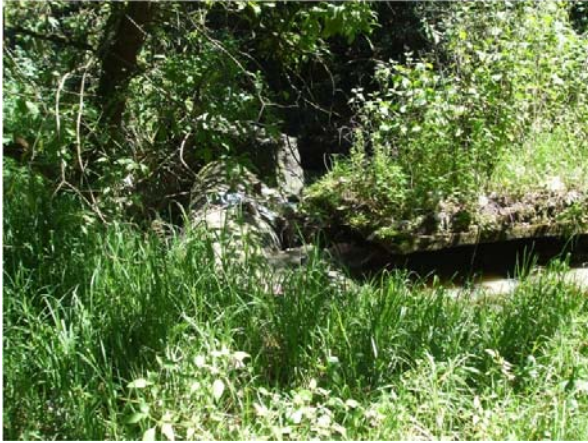
Foto 53. Tubo de drenaje y descarga
