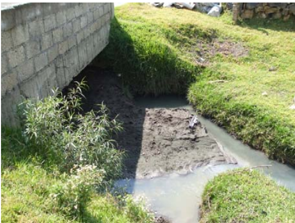
Foto 15. Azolve en el puente de la calle
