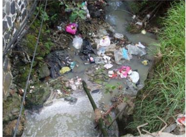
Foto. 12 Presencia de desechos sólidos
